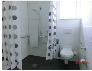
Dusche und WC mit Haltegriffen
